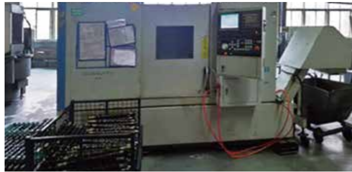
设备：机加工中心液压系统 工厂：中汽成都配件有限公司
