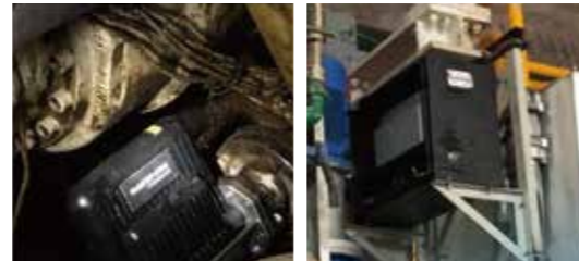
项目：安徽省合肥市某城市轨道交通工程分公司盾构公司 设备：盾构机 合肥地铁七号线#240盾构（6340mm液推）液压系统+大齿圈齿轮油系统 合肥地铁八号线#49盾构（6470mm电推）液压系统+大齿圈齿轮油系统
