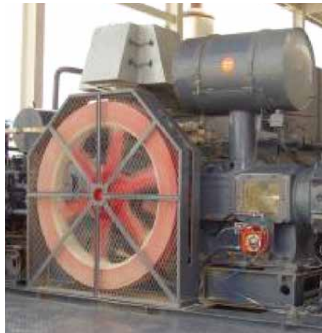
燃气发动机组/成都压缩机厂 新疆塔里木某油田作业区 中国新疆塔里木地区 自2001年起成为美孚客户
