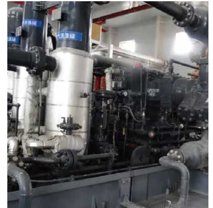
高压注气压缩机Cameron MH66 塔河油田某采气厂 中国新疆库车县
