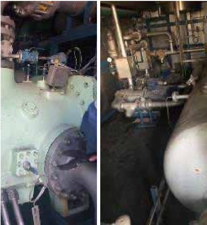
· 离心压缩机/ Siemens STC-SH · 新疆某乙烯厂车间
