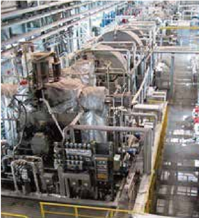
· 离心压缩机/ 西门子 STC-SH · 新疆某石化乙烯厂
